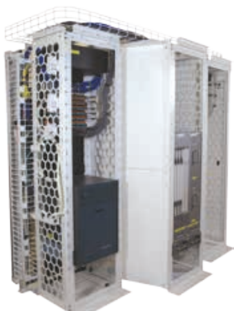
SISTEMAS DE CABLEADO ESTRUCTURADO DE ALTA DENSIDAD
