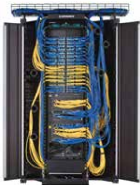
SISTEMAS DE CABLEADO ESTRUCTURADO DE ALTA DENSIDAD
