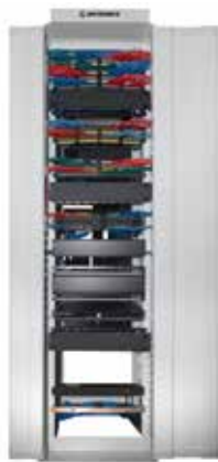
SISTEMAS DE CABLEADO ESTRUCTURADO DE ALTA DENSIDAD
