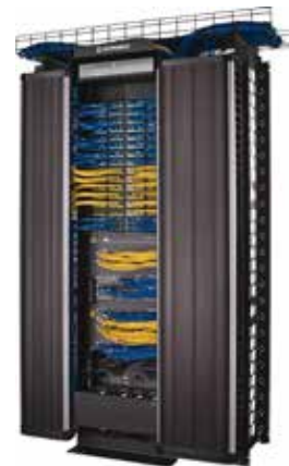
SISTEMAS DE CABLEADO ESTRUCTURADO
